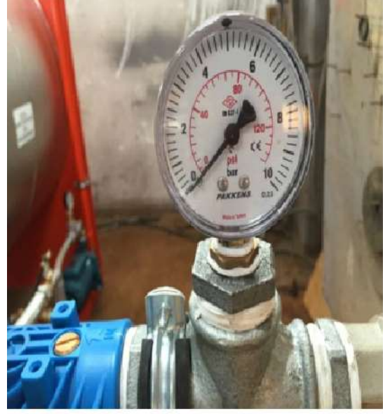
Su Yumuşatma Cihazı Su Giriş Manometresi
