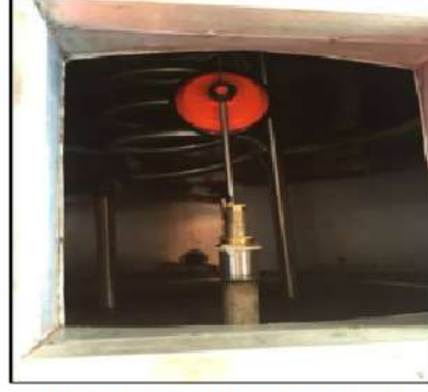
Kapağı Sökülmüş Tank
