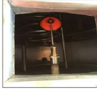
Kapağı Sökülmüş Kondens Tank
